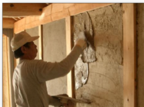
調湿作用と熱容量の大きな土壁
