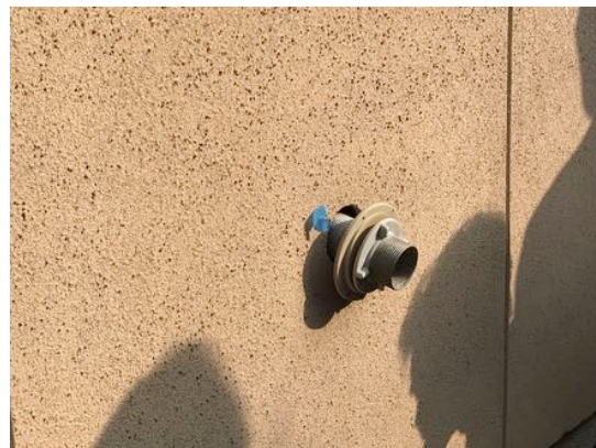
エアコン 隙間
